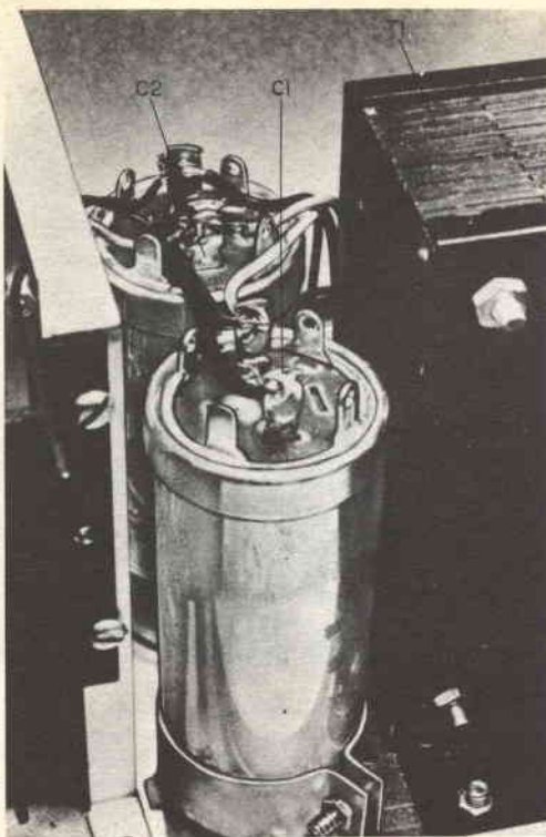
I condensatori di filtro dell'alimentatore, C1 e C2, devono essere montati sul telaio tra l'amplificatore ed il trasformatore d'alimentazione.
